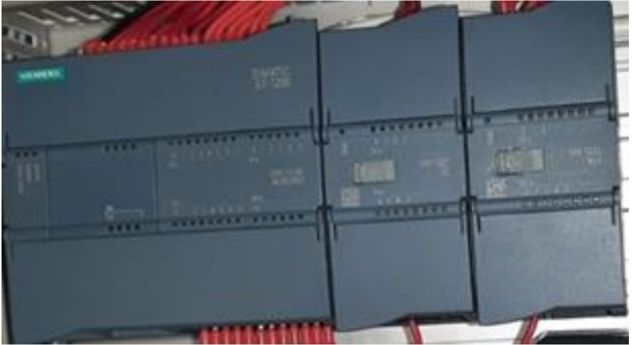
Slika 5.5 Fotografija ploče sa komandama i PLC-om koji svime upravlja
