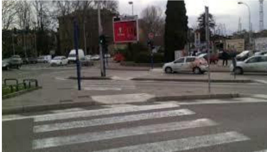
Slika 4.5. Stari i oštećen pješački prijelaz
