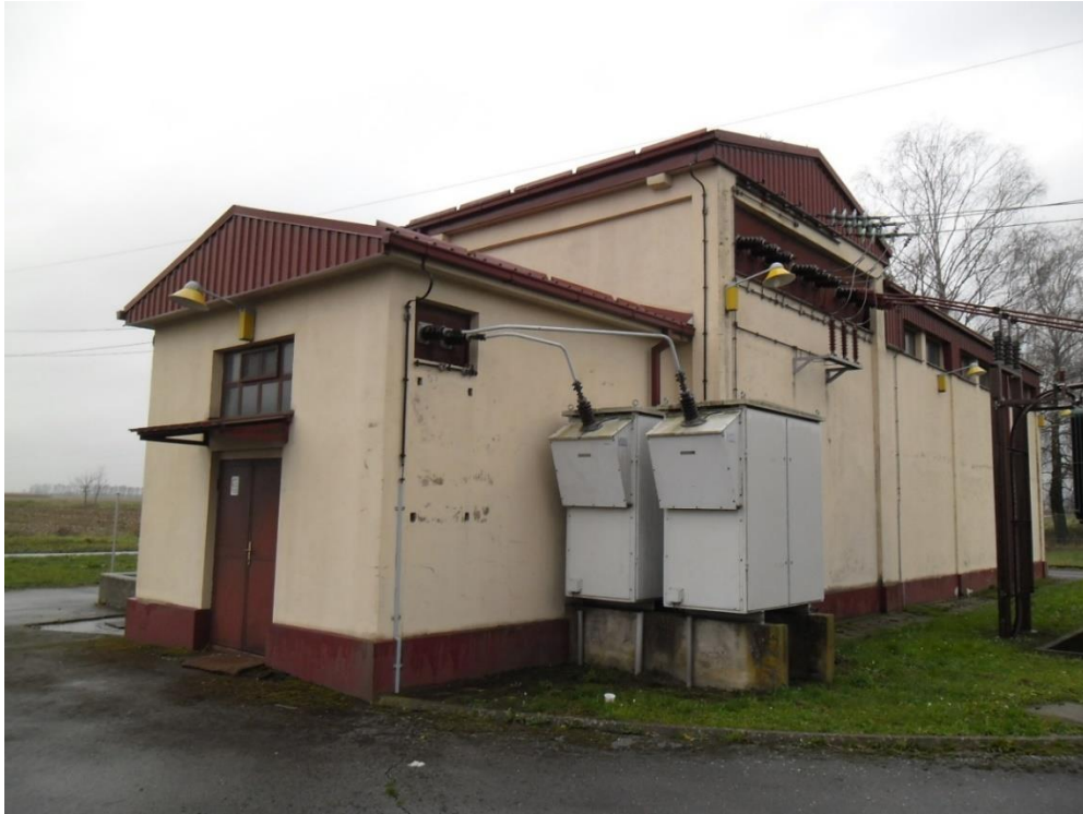
Slika 3.8: Trafostanica 35/10(20) kV Đurđevac
