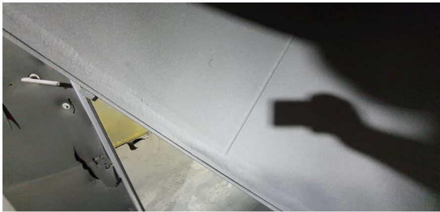
Slika 6.10: Izgled površine nakon pjeskarenja
