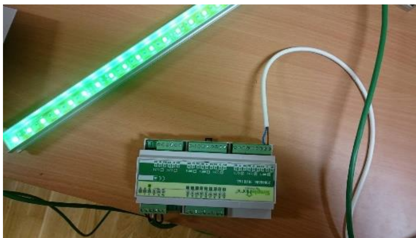
Slika 3.28. LED traka spojena na pametni relej
