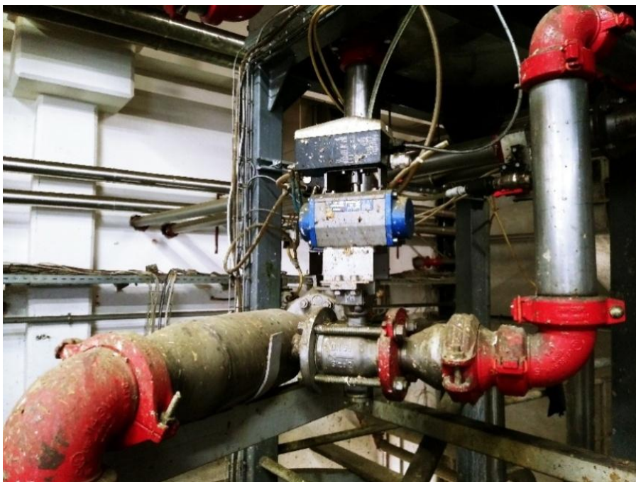
Slika 8.8: Elektro-pneumatski upravljivi ventil na cijevi strojne kade
