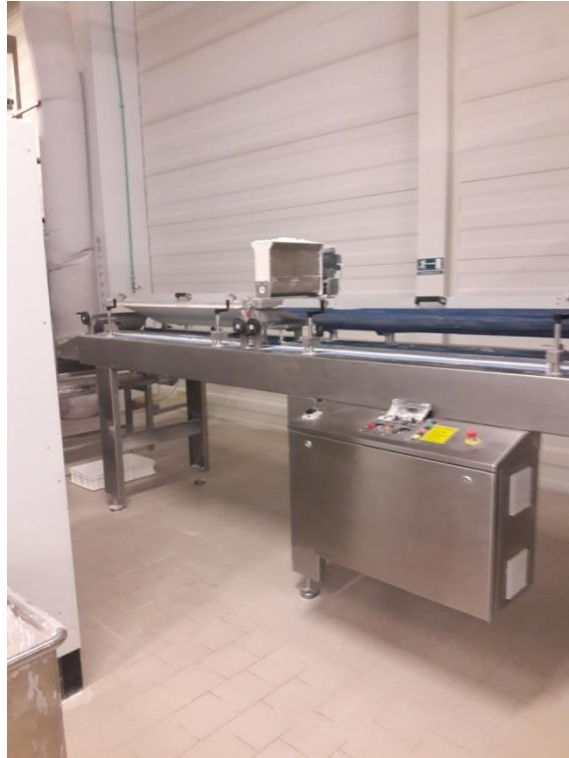
Slika7.35. Upravljački ormar stroja za savijanjetijesta, podešavajuće ploče za finalno oblikovanje i posipač brašna
