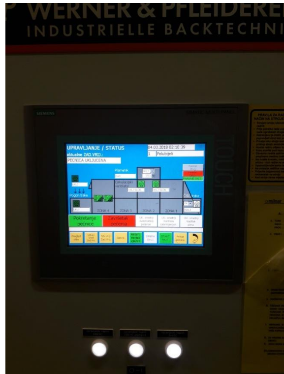
Slika 7.45. Kontrolni panel peći
