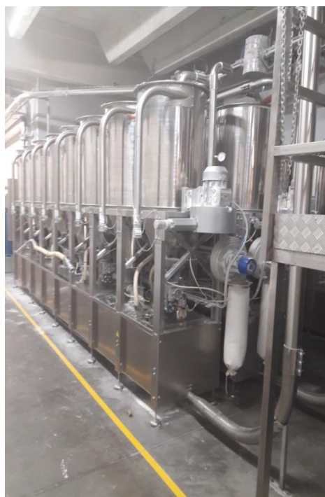
Slika 7.5. Silosi za aditive sa kompresorom za punjenje
