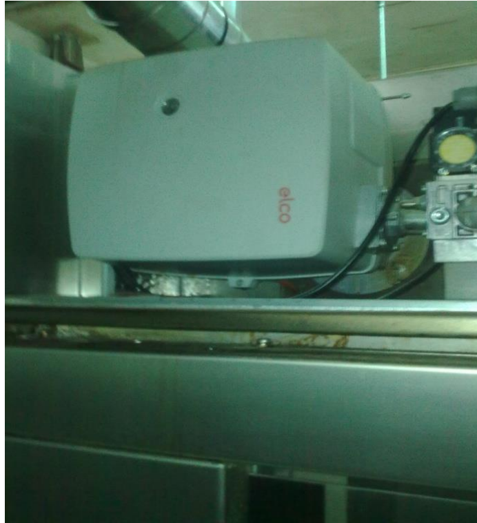
Slika 8.3. Plamenik sa pripadajućom plinskom rampom
