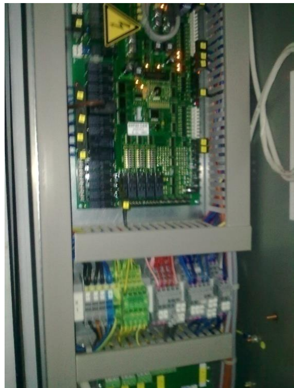
Slika 8.10. Razvodni ormar peći
