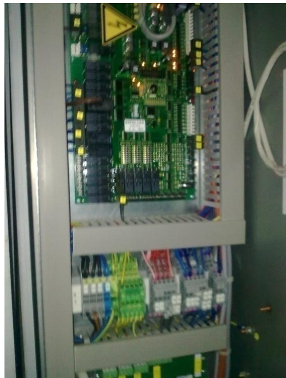
Slika 8.10. Razvodni ormar peći
