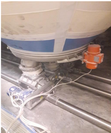
Slika 7.1. Silos brašna sa dozatorima
