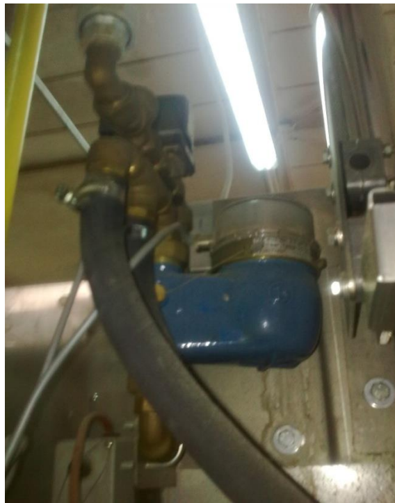
Slika 8.8. Dozator vode sa elektromagnetskim ventilom
