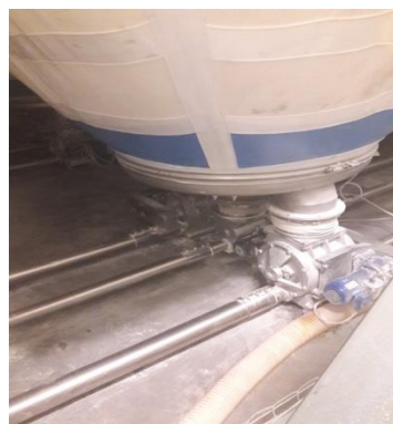
Slika 7.3. Dozatori silosa brašna
