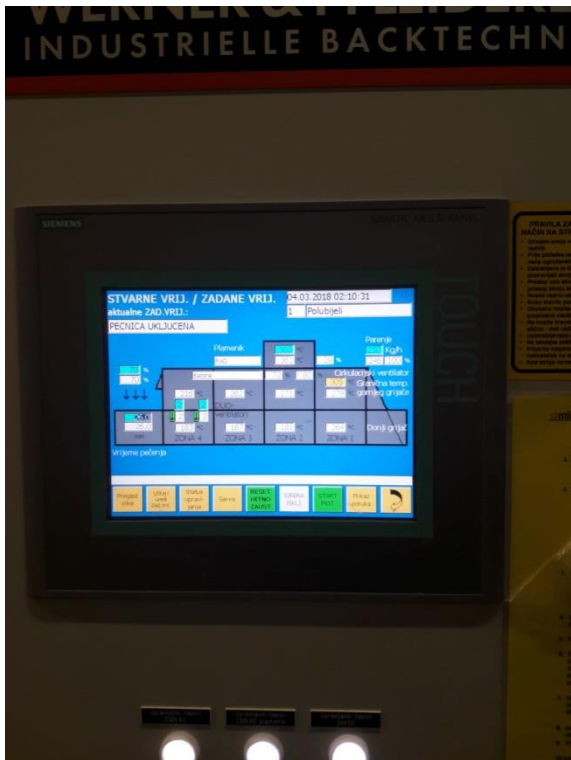
Slika 7.44. Kontrolni panel peći
