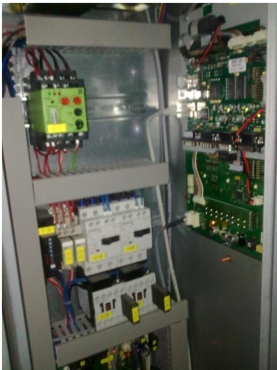
Slika 8.9. Razvodni ormar peći
