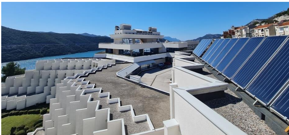
Slika 1. Solarni kolektori na GRAND hotelu Neum
