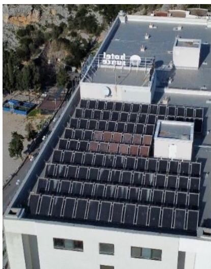
Slika 2. Solarni kolektorli na hotelu Sunce
