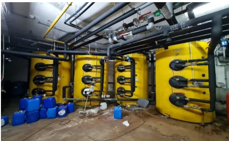
Slika 3. Bojleri za toplu vodu u GRAND hotelu Neum ( 20 000 l)
