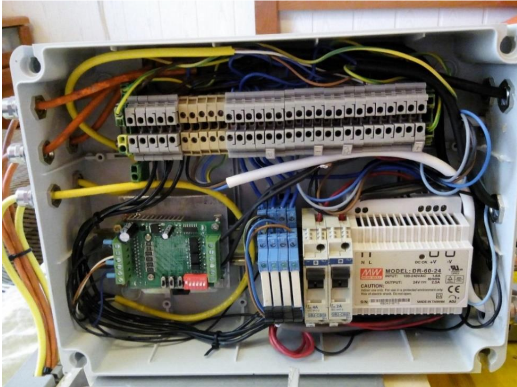
Slika 4.1. Razvodni ormar prototipa modela štanice
