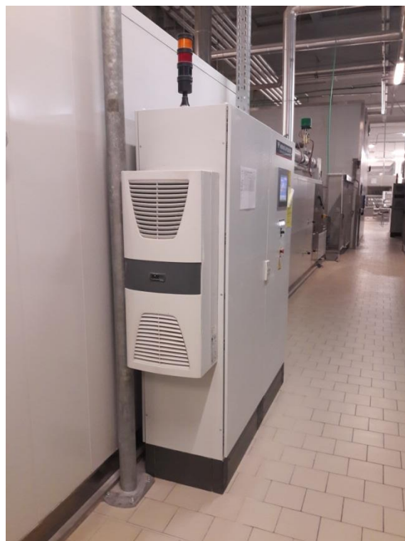
Slika 7.43. Razvodni ormar tunelske peči sa klima uređajem
