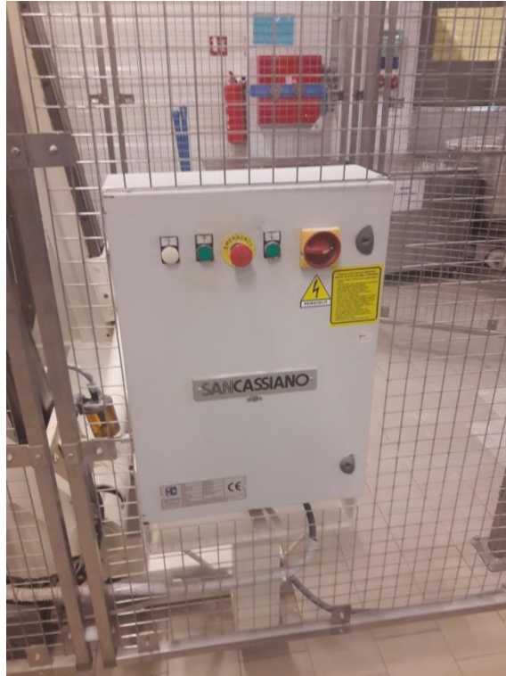
Slika 7.22. Ormarić za upravljanje radom stroja
