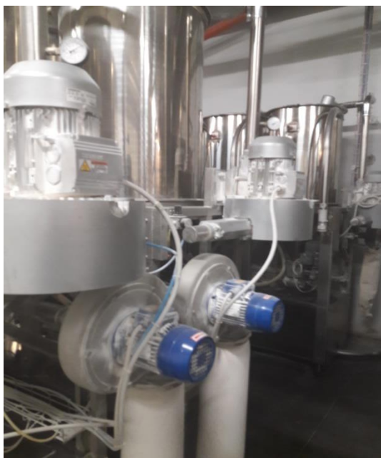
Slika 7.6. Kompresori za punjenje silosa za aditive
