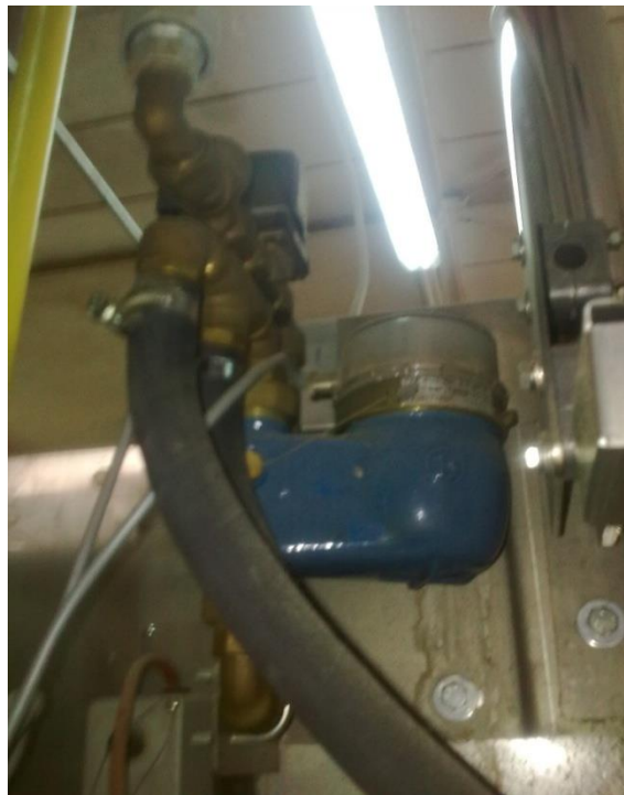
Slika 8.8. Dozator vode sa elektromagnetskim ventilom
