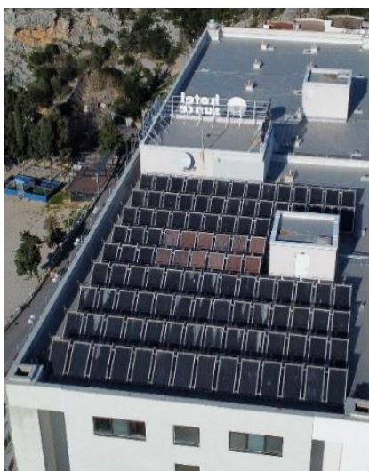
Slika 2. Solarni kolektorli na hotelu Sunce
