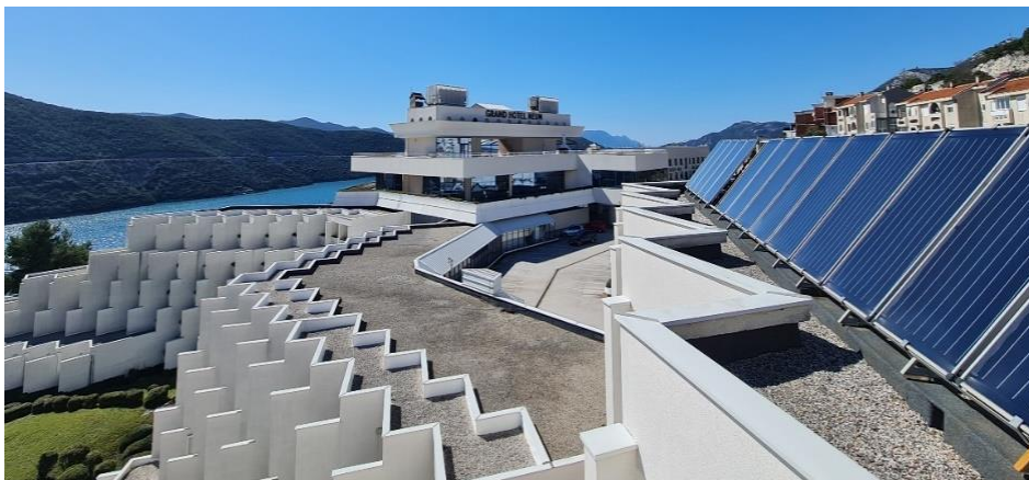
Slika 1. Solarni kolektori na GRAND hotelu Neum
